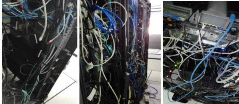
Figura 3. Cableado de los racks
